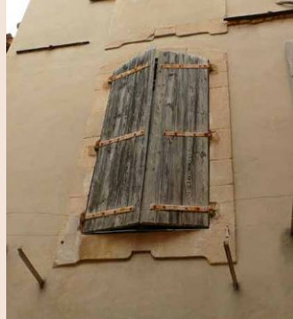
Enduit venant buter sur l'encadrement de pierre en saillie.
